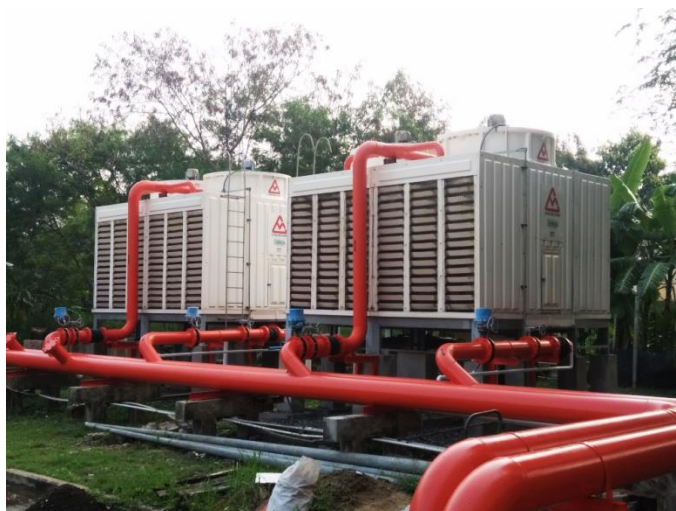
รูปที่ 3 หอระบายความร้อน (Cooling Tower)
