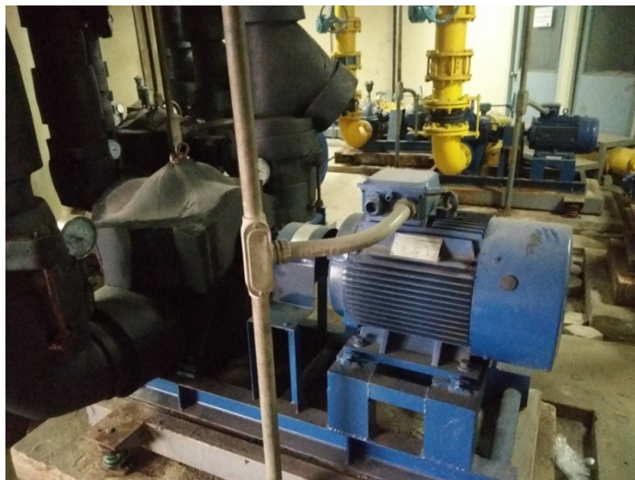
รูปที่ 5 ปั๊มน้ำเย็น
