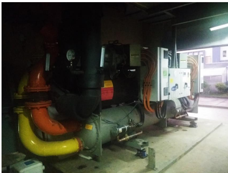
รูปที่ 1 เครื่องทำความเย็น (Chiller)
