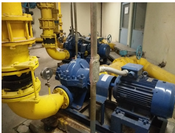
รูปที่ 4 ปั๊มน้ำร้อน
