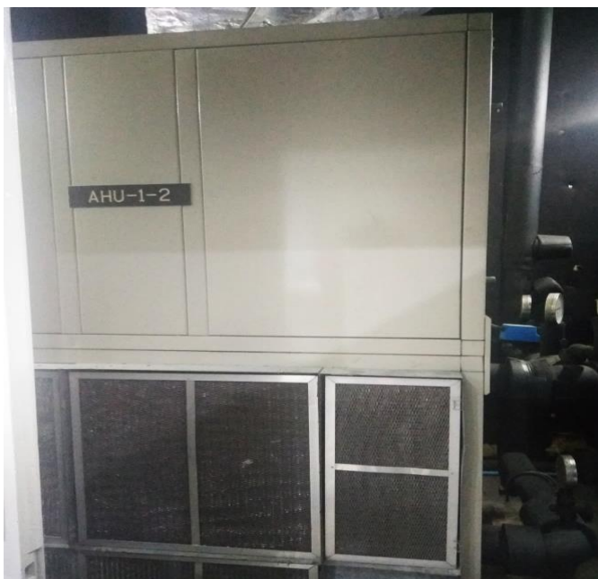
รูปที่ 9 เครื่องจ่ายลมเย็น (Air Handling Unit, AHU)
