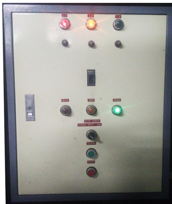
รูปที่ 10 ตู้ควบคุม AHU
